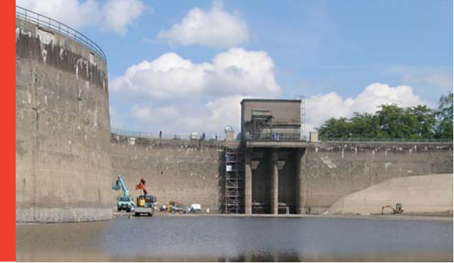
Oberbecken bei der Inspektion im Frühjahr 2005.
