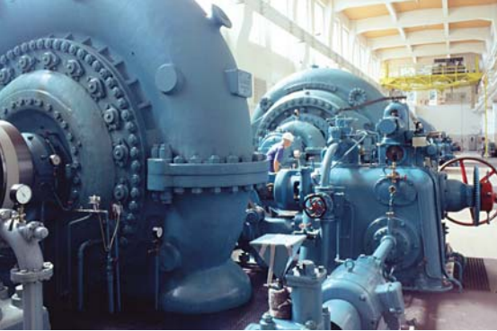
Turbinen im Kraftwerk Waldeck I.
